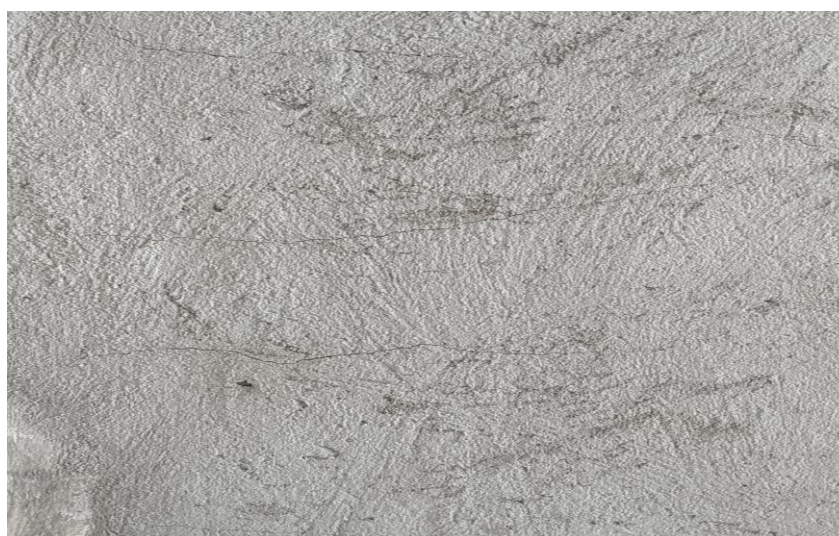
Figura 9 – Fissura de Retração
