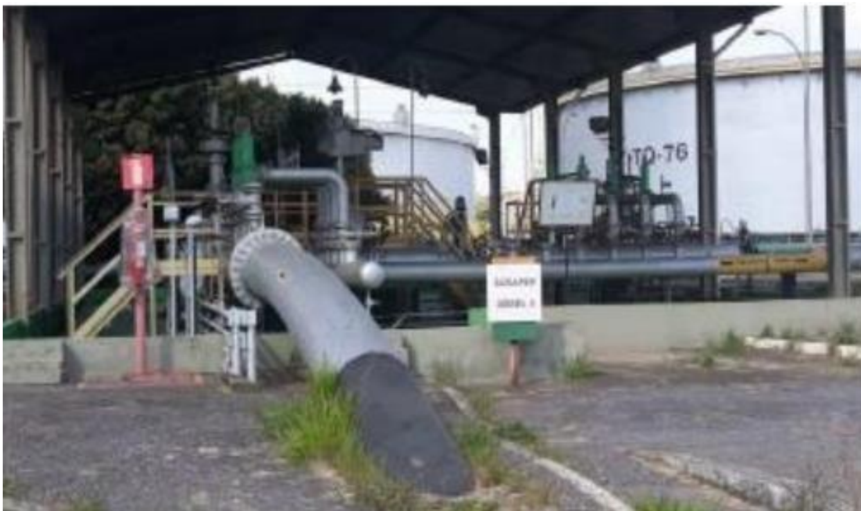
Figura 07: Dutos dedicados ao combustível de aviação ou multiprodutos.
