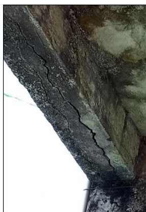
Figura 7: Manifestação patológica em viga de concreto armado.
