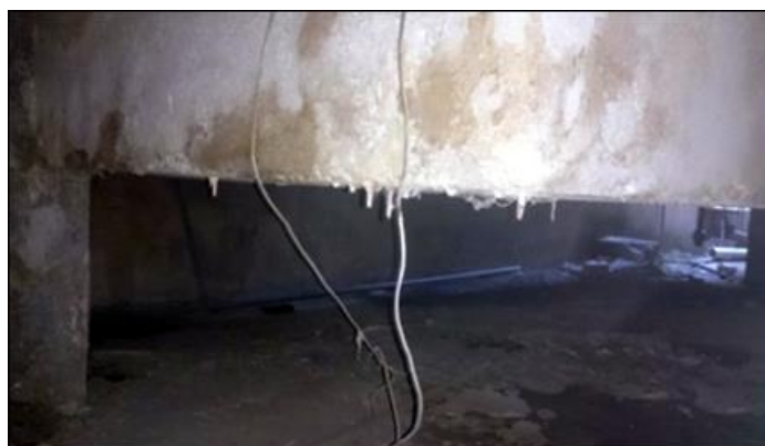
Figura 2: Lixiviação em Viga de Concreto Armado.
