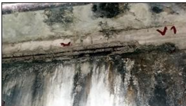
Figura 14: Viga com armadura exposta antes do tratamento.
