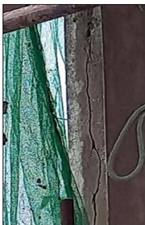
Figura 8: Rachadura vertical estrutural em pilar.
