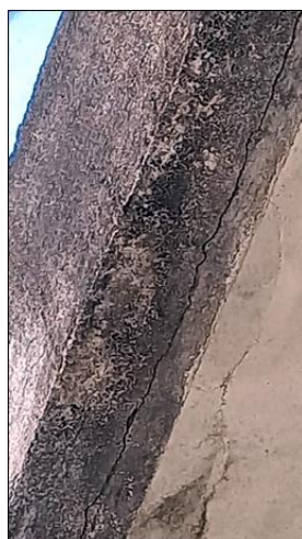
Figura 8: Manifestação patológica em uma viga próxima.
