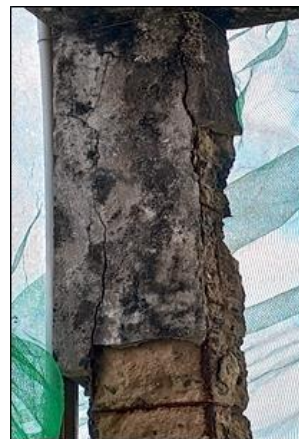
Figura 9: Deslocamento em pilar.
