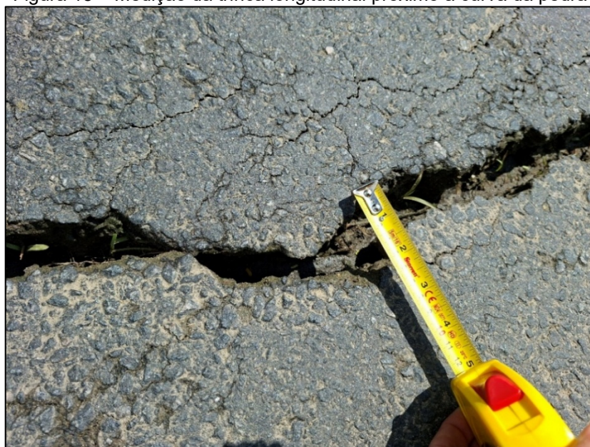
Figura 18 – Medição da trinca longitudinal próximo à curva da pedra
