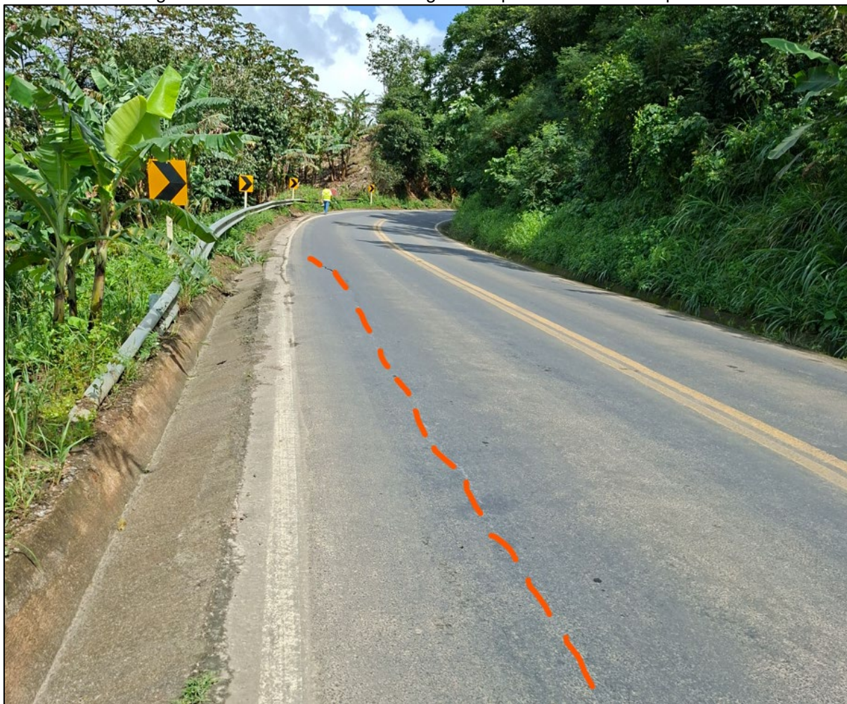
Figura 19 – Extensão da trinca longitudinal próximo à curva da pedra
