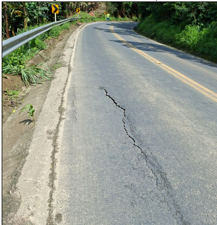
Figura 17 – Trinca longitudinal no trecho em aterro próximo à curva da pedra
