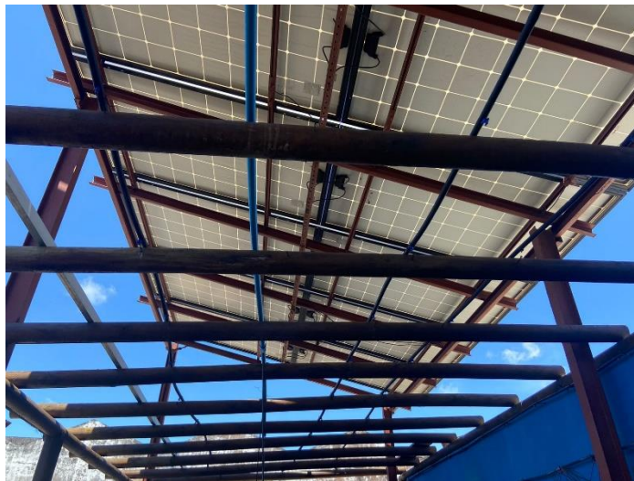
Figura 04- Vista Inferior das placas fotovoltaicas
