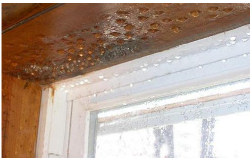
Figura 3 - Infiltração por condensação.
