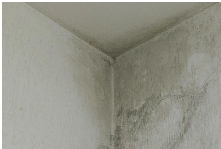
Figura 2: Infiltração causada por intempéries.
