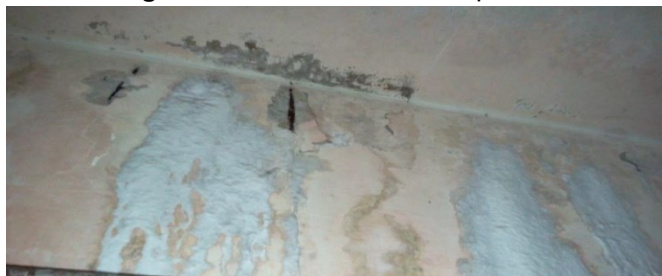
Figura 3 - Eflorescências nas paredes
