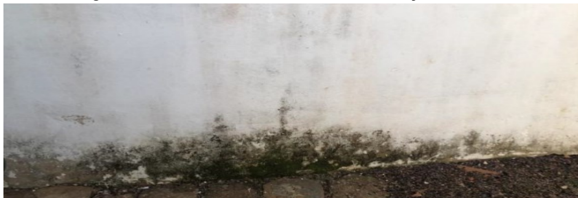
Figura 1 - Parede externa com manifestação de mofo
