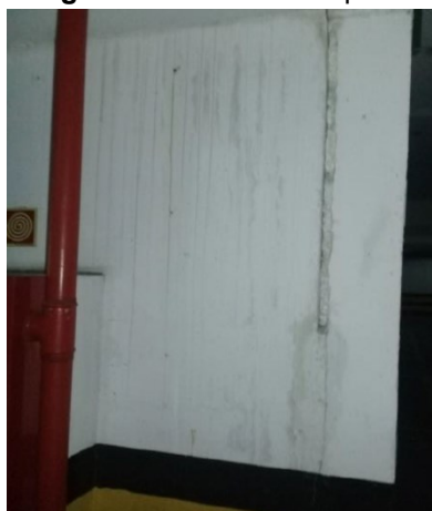
Figura 2 - Manchas no pilar
