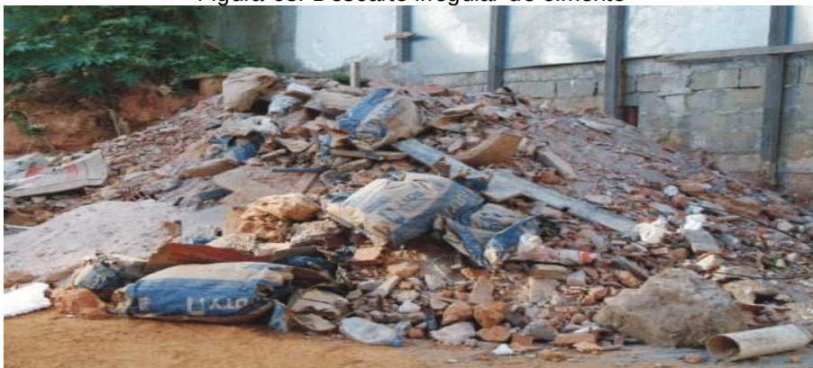
Figura 03: Descarte irregular de cimento
