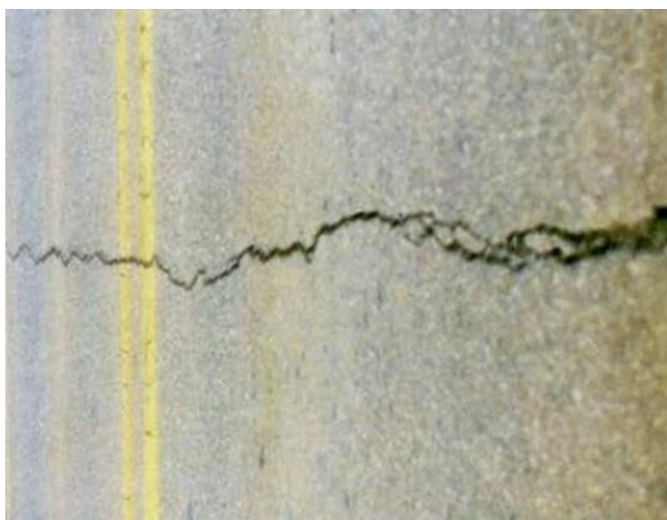
Figura 15 - Trinca por reflexão
