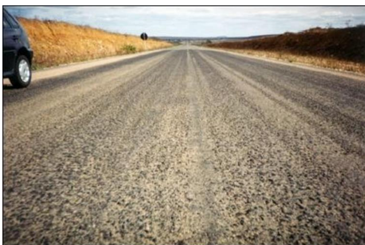
Figura 10 - Desgaste em pavimento
