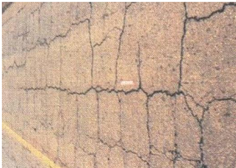
Figura 14 - Trincas em blocos no pavimento
