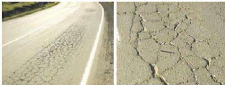
Figura 13 - Fissura por fadiga de grande medida
