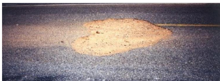
Figura 17 - Buraco em pavimento de seriedade média
