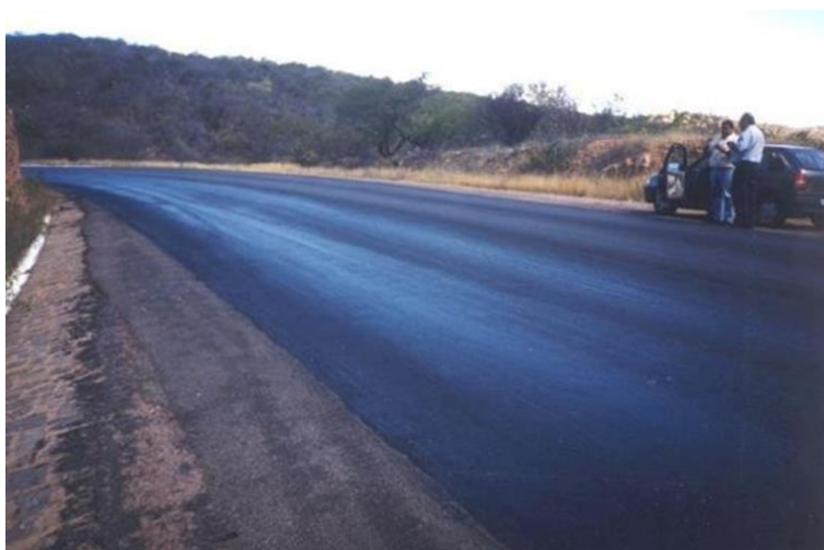
Figura 12 - Exsudação ocorrido em pavimento rodoviário
