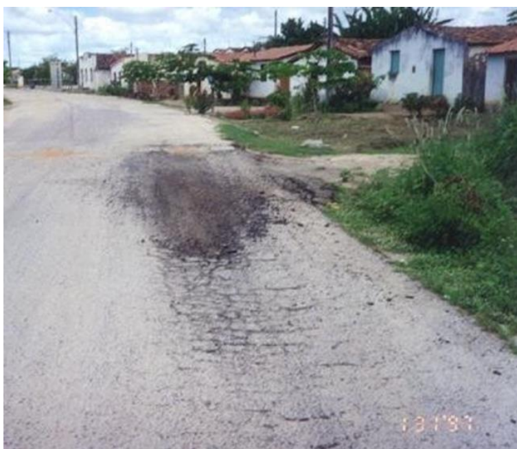
Figura 19 - Deformação plástica no pavimento
