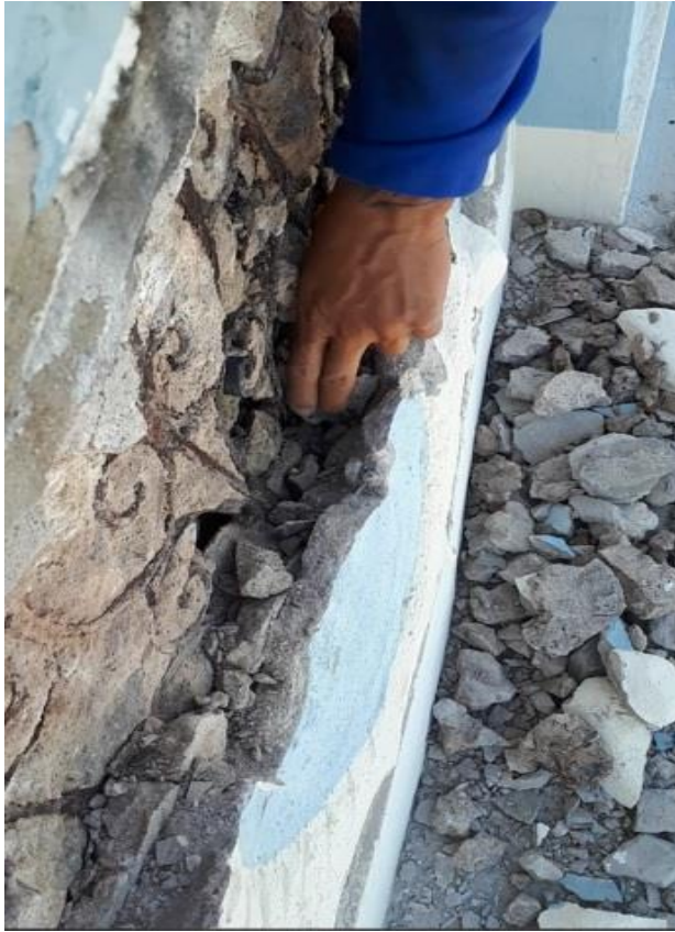
Figura 30. Concreto desagregando do aço
