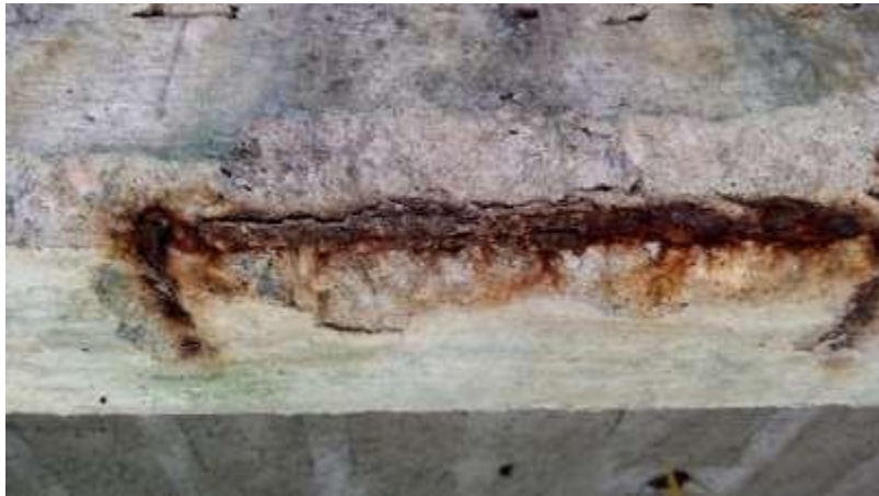
Figura 11 - Estrutura de Concreto armado sob ataque de cloreto
