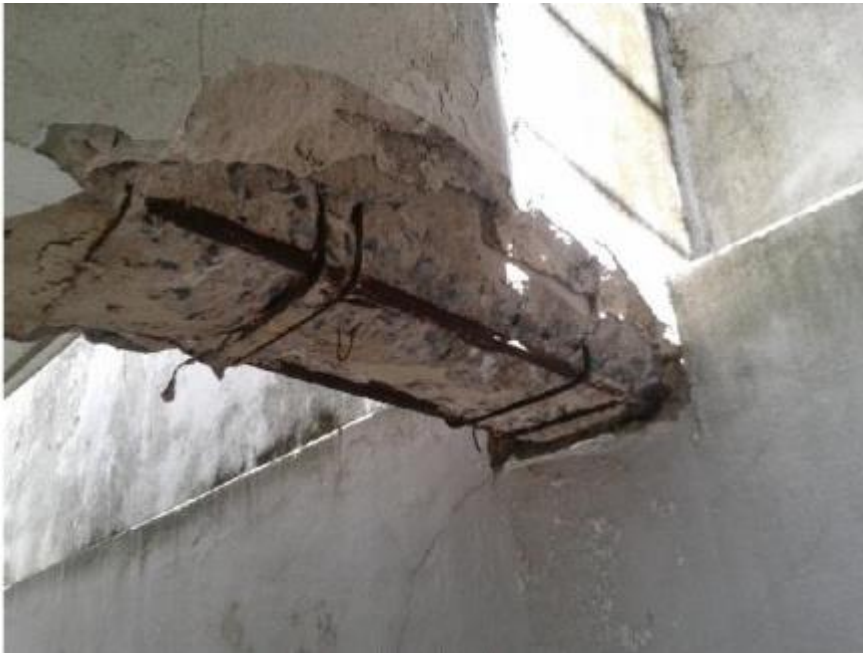
Figura 2. Deslocamento do concreto em viga.
