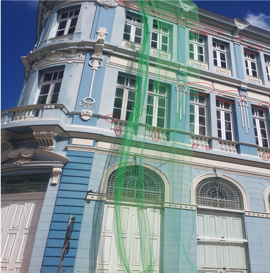
Figura 26. Deslocamento do revestimento argamassado do edifício
