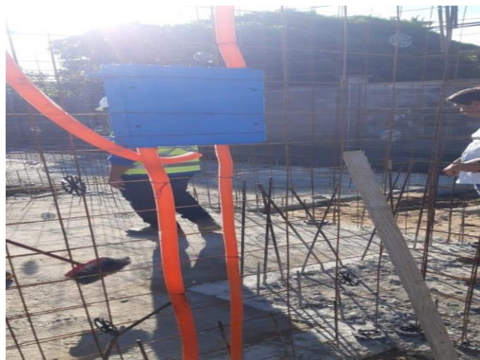
Figura 9- Quadro elétrico parede de concreto
