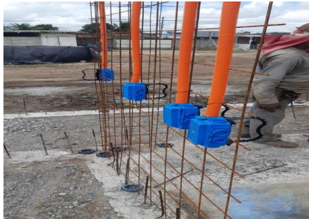
Figura 8 – Caixa elétrica parede de concreto
