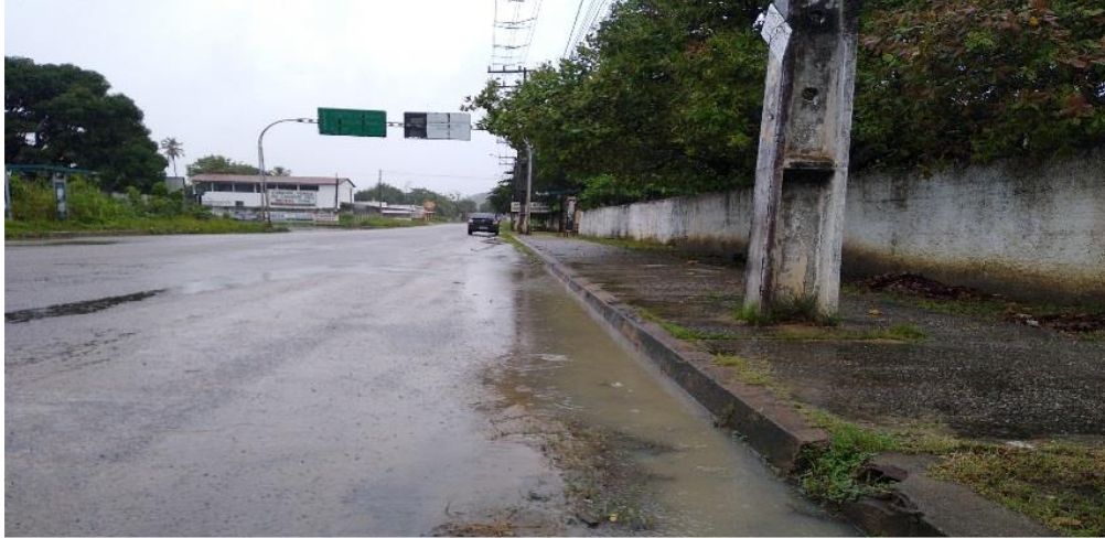
Figura E – Acúmulo de água por sistema de escoamento ineficiente
