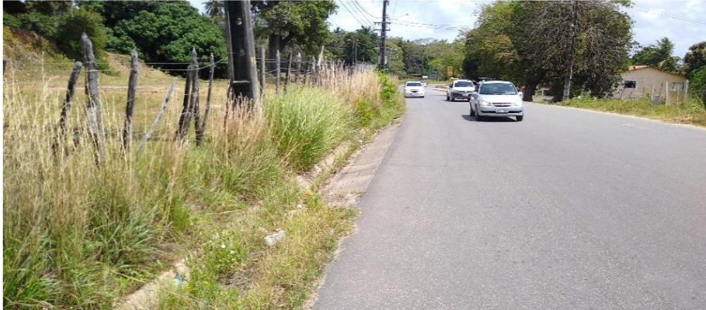
Figura G – Sarjetas obstruídas e inapropriadas
