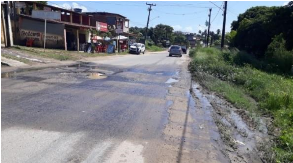
Figura F – Erosões no pavimento
