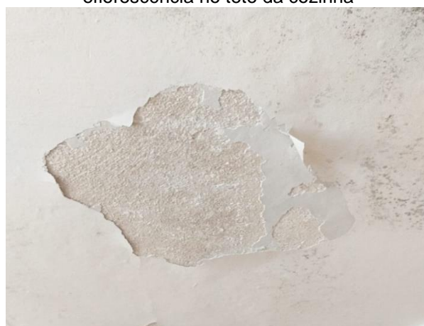
Figura 8 – Descascamento de pintura e eflorescência no teto da cozinha
