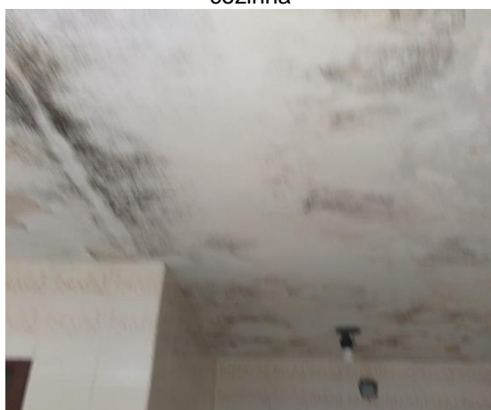
Figura 7 – Infiltração e bolor no teto da cozinha
