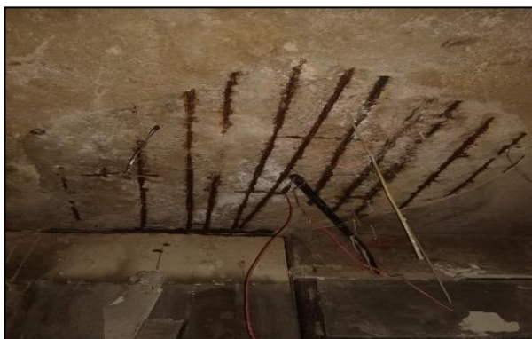
Figura 8 – Corrosão em armadura
