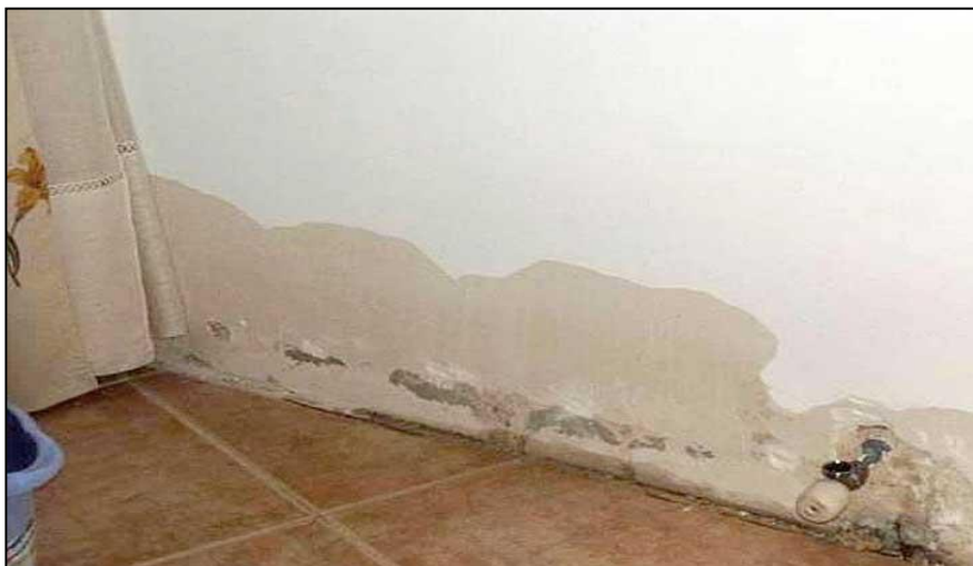
Figura 1 – Infiltração proveniente de capilaridade
