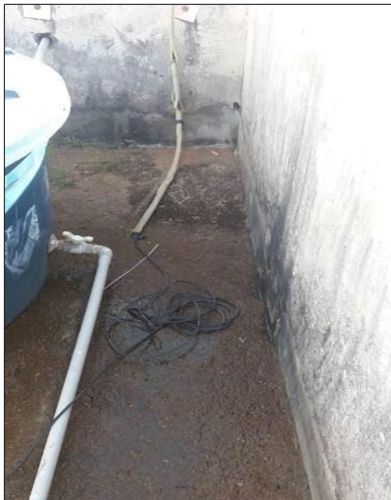
Figura 16 – Infiltração proveniente da laje
