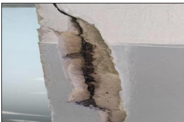
Figura 9 – Corrosão em armadura
