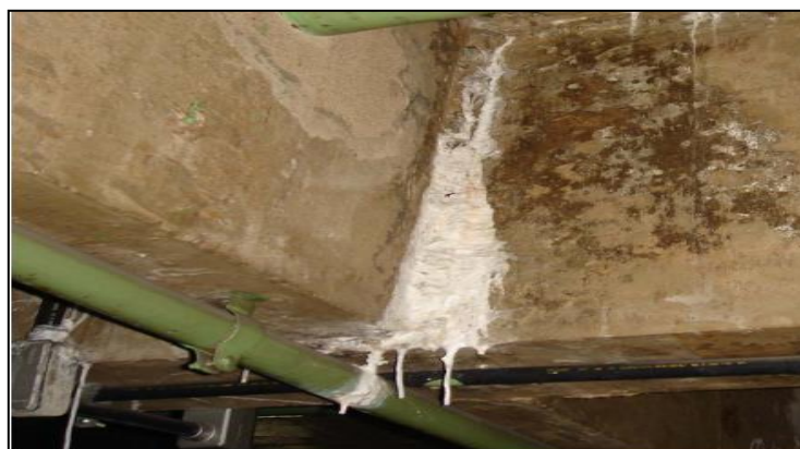
Figura 4 – Eflorescência em encontro de vigas em pavimento de garagem
