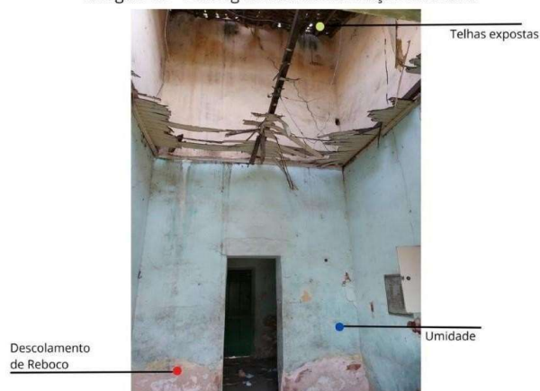
Imagem 08 – Patologias internas da Estação ferroviária
