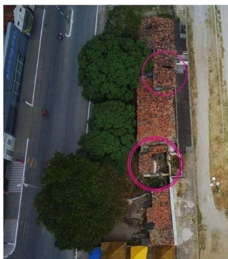
Imagem 10– Coberta da Estação ferroviária cedendo
