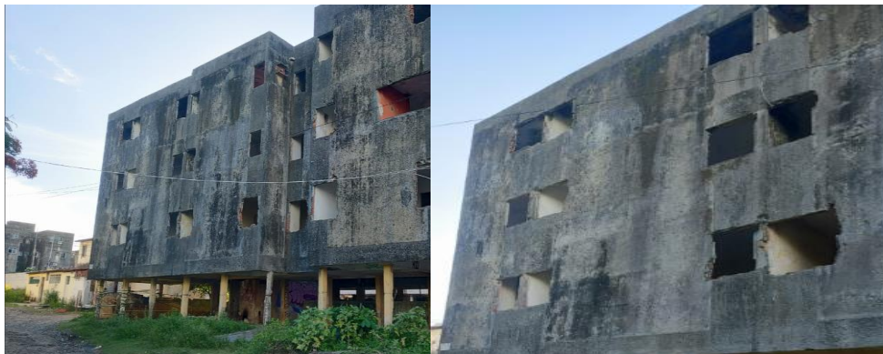
Figura 6 - Prédio interditado no bairro de Rio Doce.
