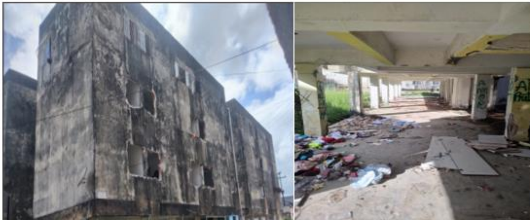
Figura 11 - Prédio Abandonado em Rio Doce, Olinda
