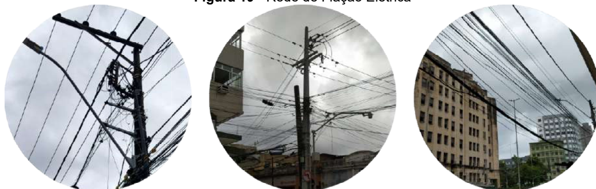
Figura 19 - Rede de Fiação Elétrica
